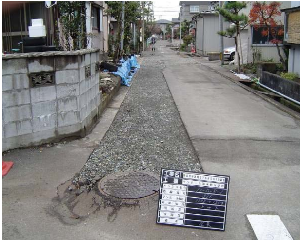
No.1 マンホール隆起
