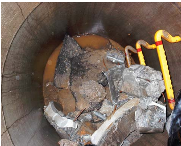
No.5 直壁破損
