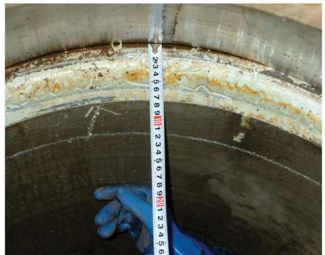
No.4 斜壁ずれ
