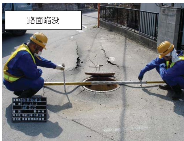
写真 6. 6. 3. (1) マンホール蓋周辺の被災箇所測定
