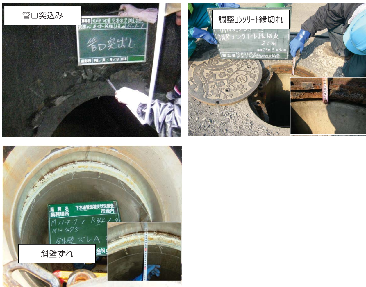
写真 6. 6. 3. (2) マンホール内の損傷程度の明示
