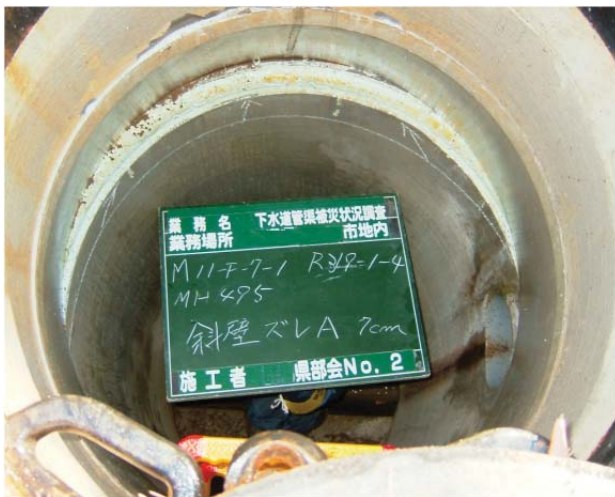
No.3 斜壁ずれ
