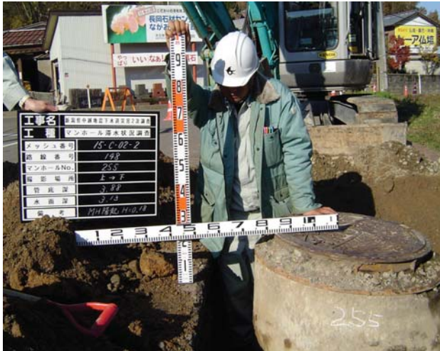
No.1 マンホール隆起
