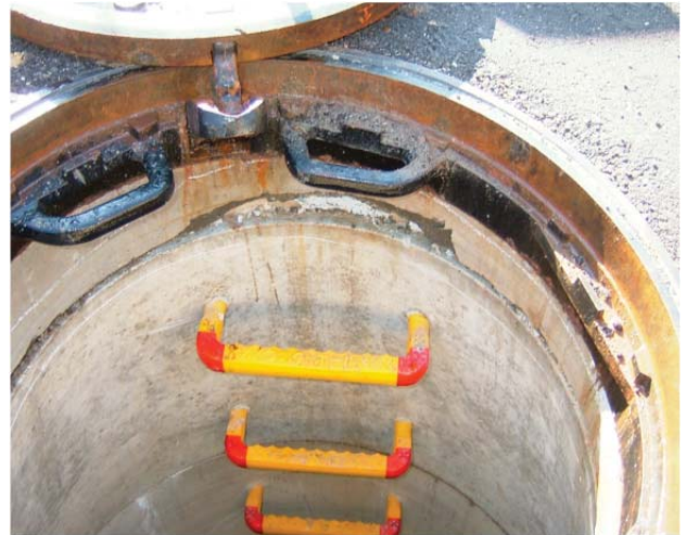
No.2 調整リング破損
