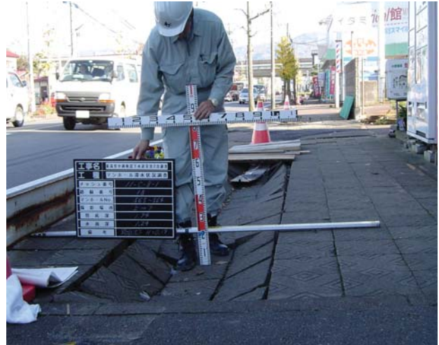
No.2 路面陥没
